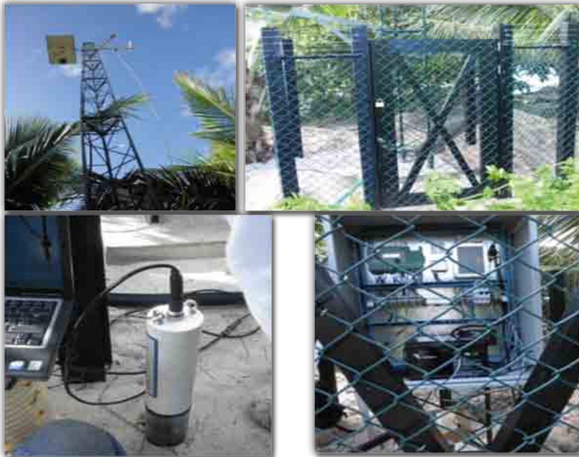
Figura 31 Estación de Johnny Cay instalada en marco del proyecto
